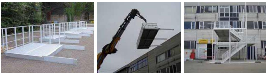
Een kraan maakt het mogelijk om voorgemonteerde elementen aan de constructie te bevestigen
